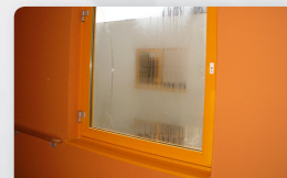
Zarositev med šipama je znak napake v tesnjenju ali mehanske poškodbe
