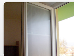
Zarošena zunanja šipa nakazuje dobre toplotne lastnosti zasteklitve
