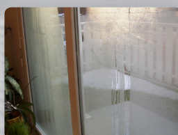
Zarošena notranja šipa sodobne zasteklitve pričča o neprimerni notranji mikroklimi
